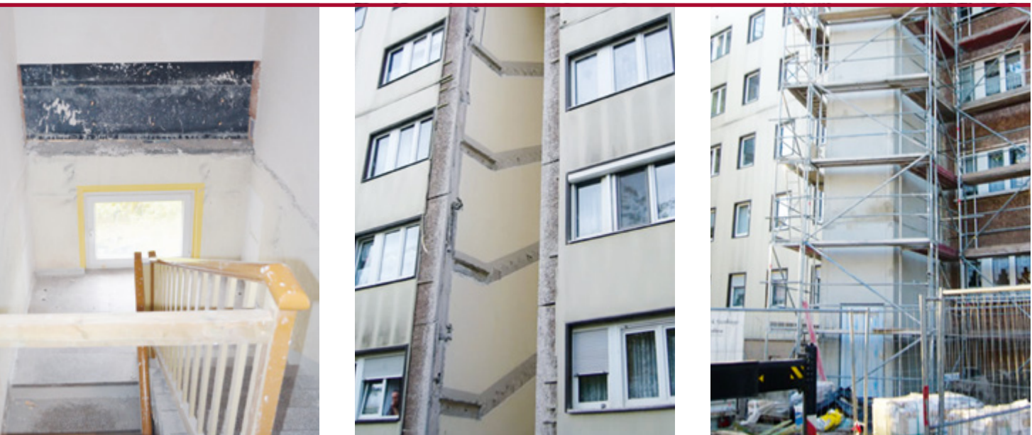
Die Wände vom Treppenhaus zur Hofseite des Gebäudes werden ausgeschnitten und damit Platz für die Aufzüge geschaffen. Die beiden rechten Fotos geben eine Vorschau auf die bevorstehenden Arbeiten (sie zeigen ein früheres Projekt).
